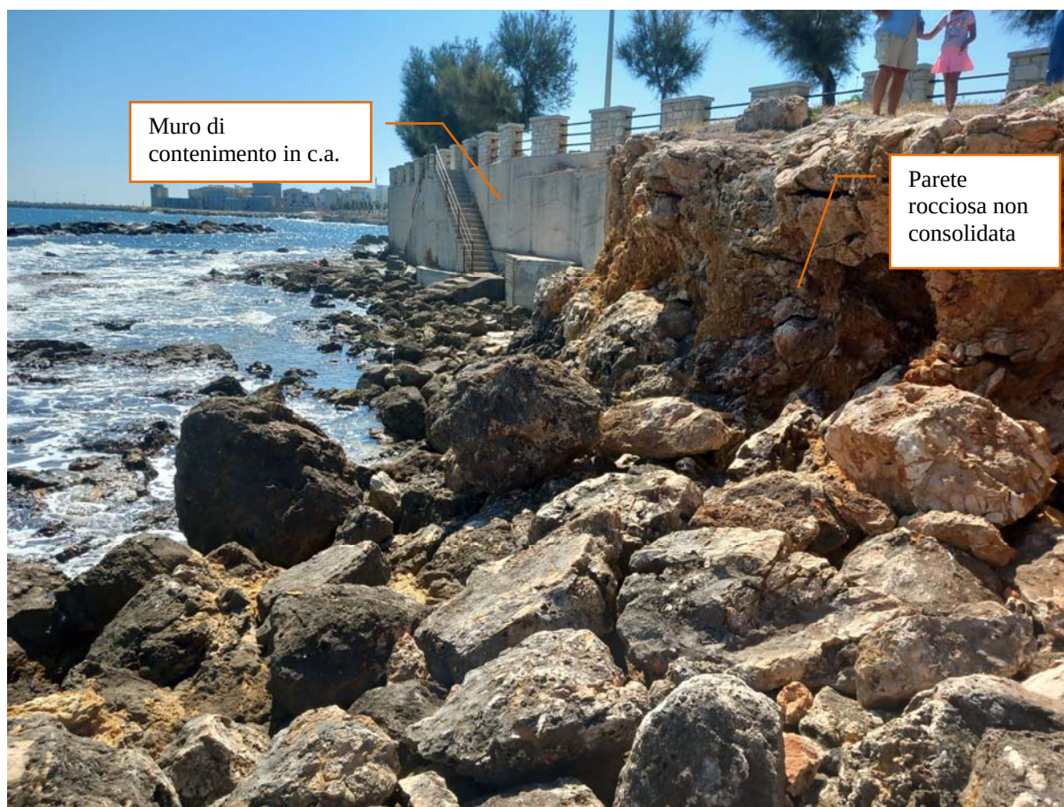
Foto 3.3: Porzione della parete rocciosa del PG3 non consolidata
