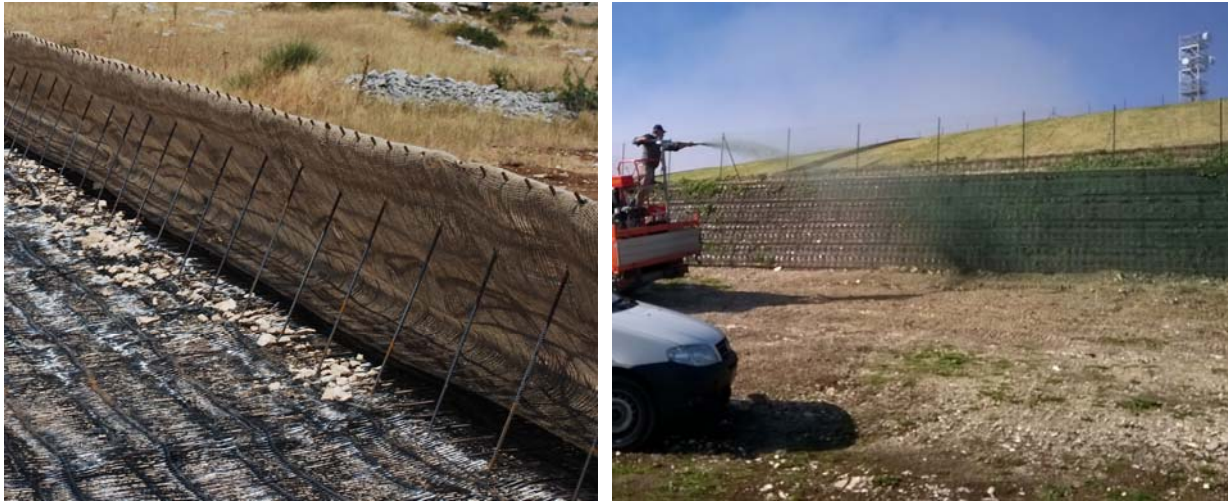
Figura 33 Particolare terra armata (cassero di guida in rete elettrosaldata, elemento antierosione, geogriglia di rinforzo e tiranti di tenuta) e idrosemina
